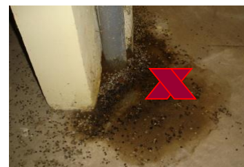
H40: Nền kho bị đọng nước
